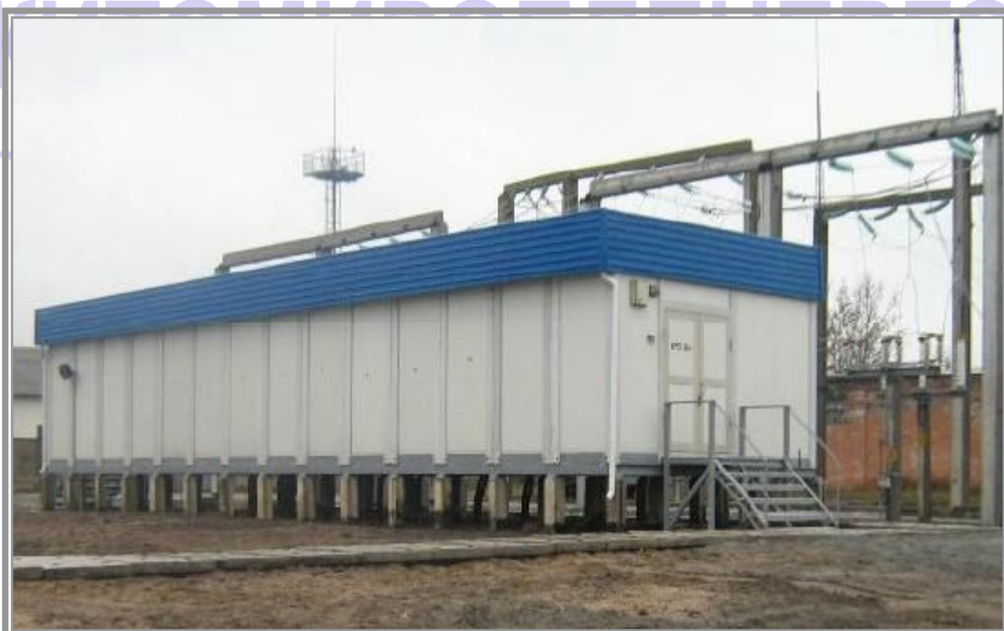
Нове обладнання ПС 110/35/10 - кВ "Смолянка"
