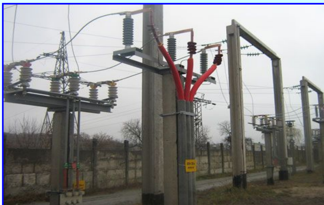
ОРУ-110 кВ ПС „Смолянка” 110/35/10 кВ в м. Житомирі
